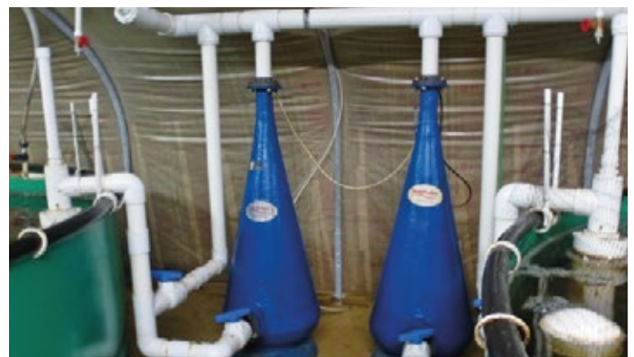
Figura 8 - Oxigenación del agua antes de su retorno a los tanques, utilizando conos para incorporar oxígeno al agua.
