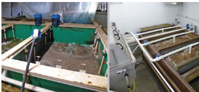
Figura 7 - Imágenes de filtros biológicos auto limpiantes que utilizan como sustrato partículas plásticas fluidizadas. Estos filtros disponen de aireación por difusores en su interior.
